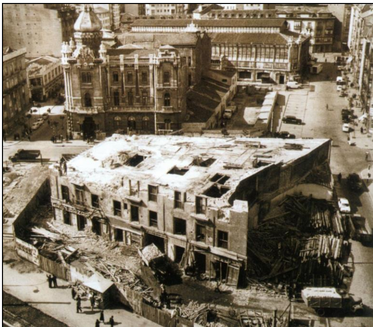
Fig. 6. Antigua manzana de Almacenes Sepi, durante su derribo, apreciándose la medianera con la singular solución cóncava determinada por la cerca medieval. (Cobo de la Hera, p. 188). Colección Thomas/CDIS.
